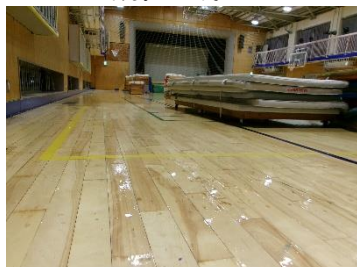
雨漏り後の体育館
